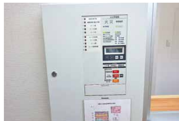
Sスポーツプラザ京都伏見様 火災報知設備設置工事
