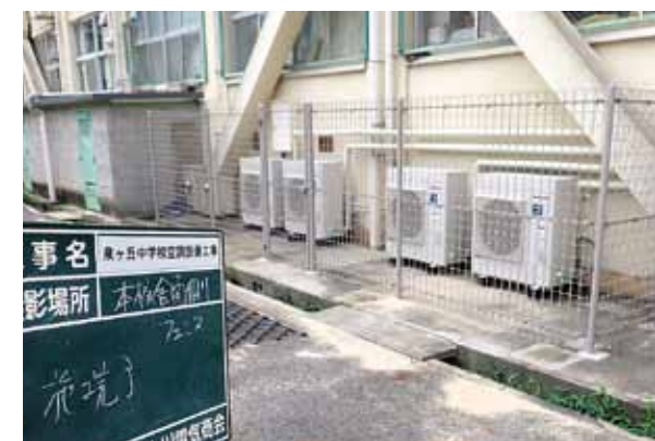
泉ヶ丘中学校様（空調設備工事）
